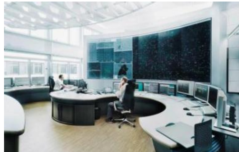
Hauptschaltleitung der TransnetBW in Wendlingen
