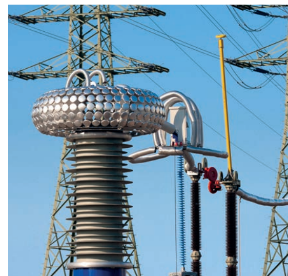
Versuchsstation von Amprion und TransnetBW zur ersten Gleichstrom-Wechselstromverbindung
