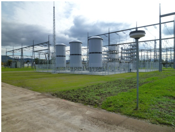
Blick auf die Kondensator-Anlage im Umspannwerk Engstlatt. Im Vordergrund stehen drei Drosselspulen, dahinter zeigt sich die Schaltanlage.
