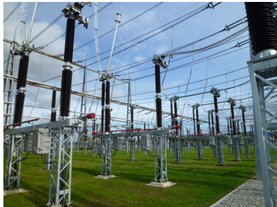
Blick in die 380-kV-Anlage im Umspannwerk Engstlatt.
