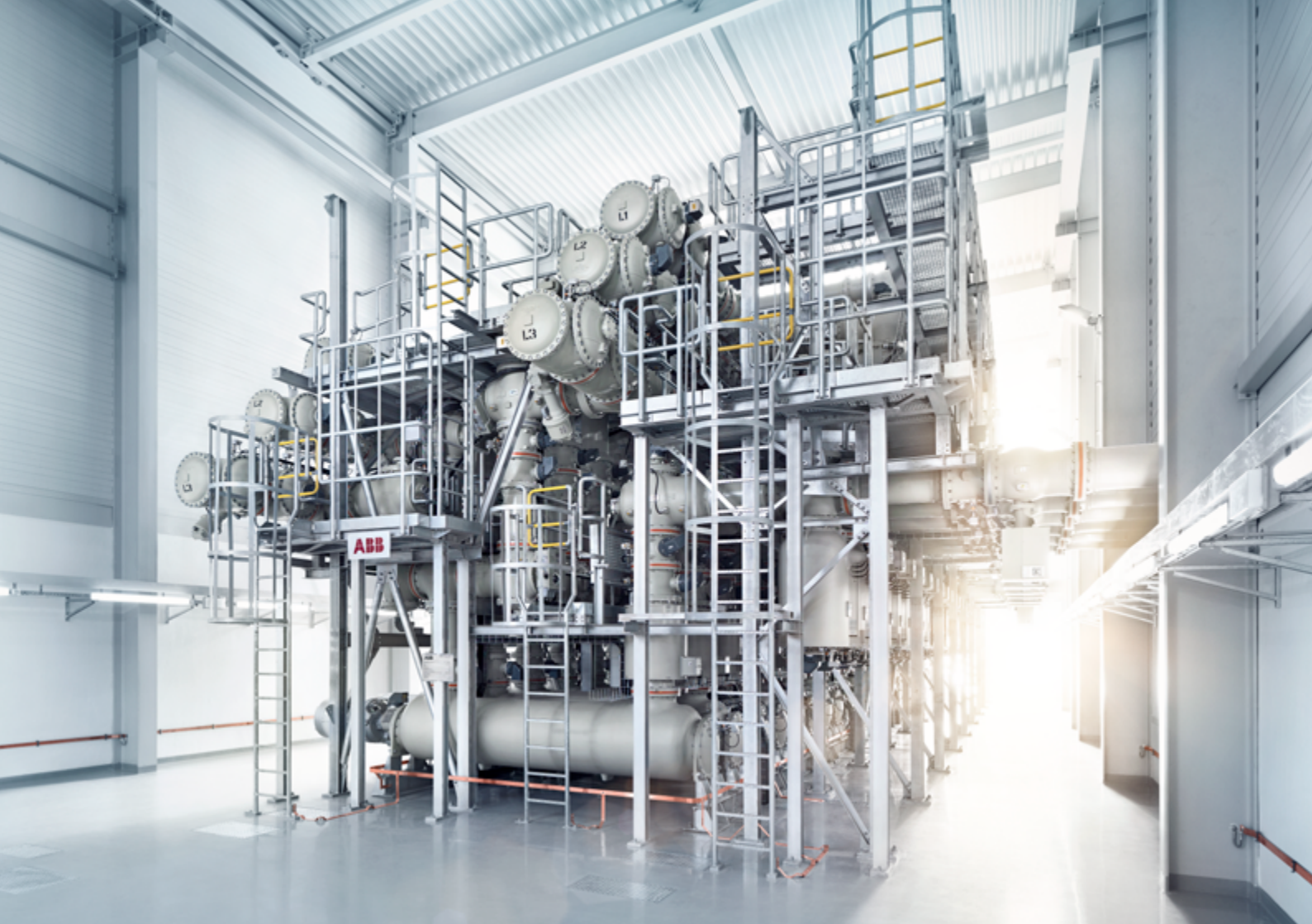
Gasisolierte Schaltanlage im Umspannwerk Weier
