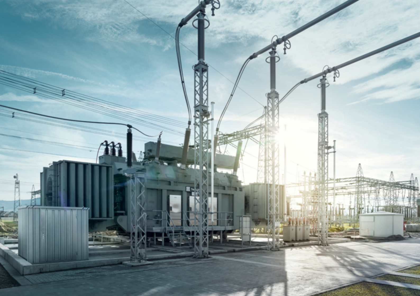
220-/110-kV-Transformator im Umspannwerk Weier
