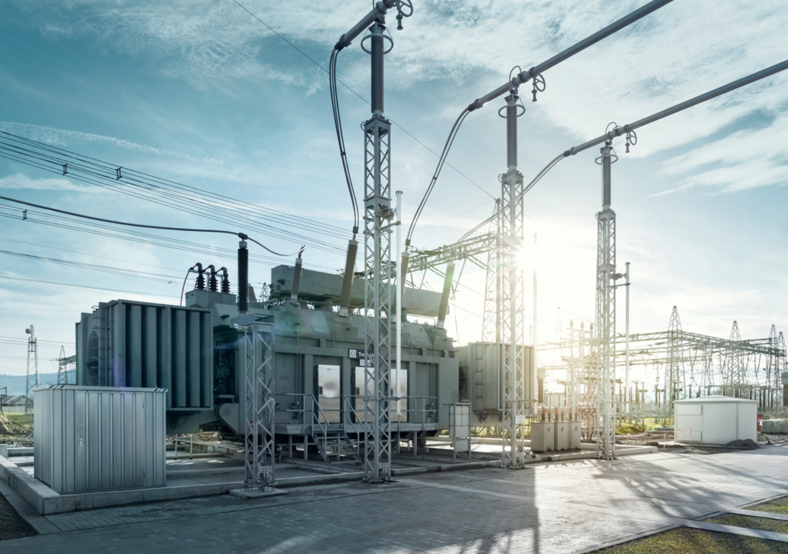
220-/110-kV-Transformator im Umspannwerk Weier
