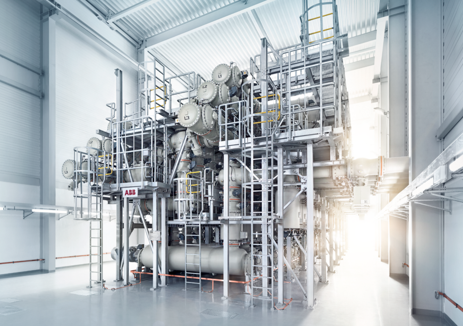
Gasolierte Schaltanlage im Umspannwerk Weier
