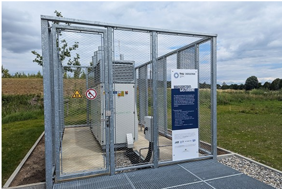
Abbildung 3.9: Gasturbine mit Zugangsschutz
