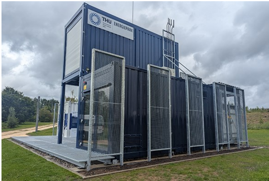
Abbildung 3.10: H_2 -Labor als Bestandteil des Energieparks
