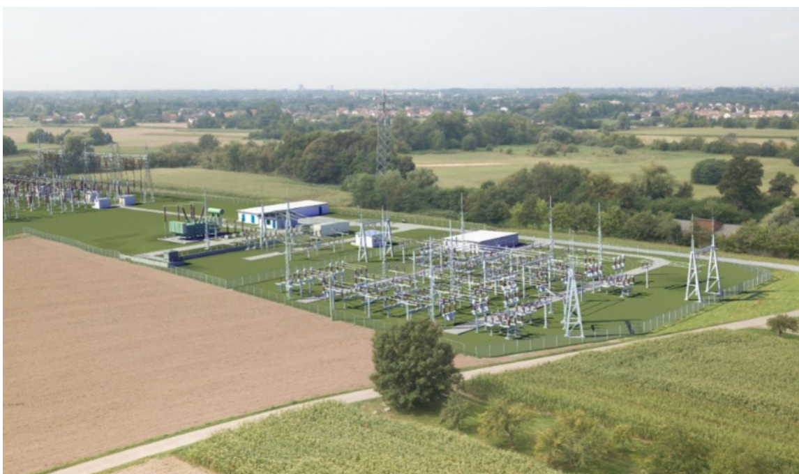
Das geplante Umspannwerk Kork zwischen den Gemeinden Neumühl und Kork.
