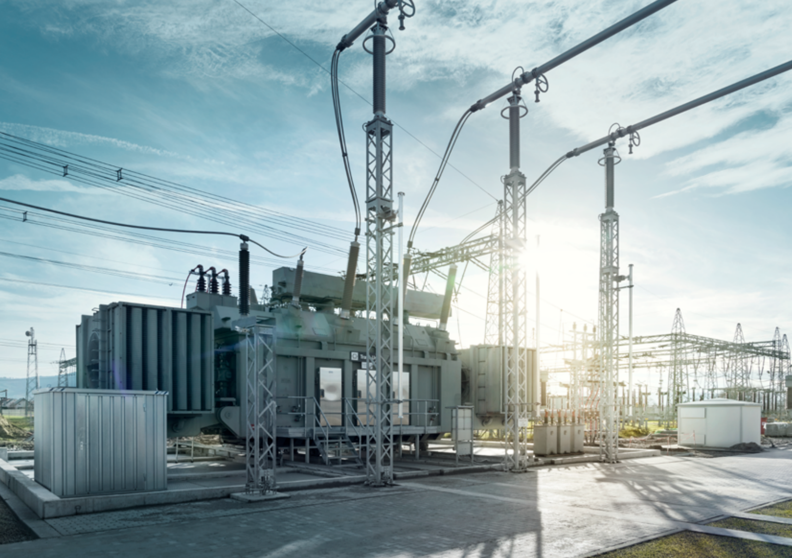
220-/110-kV-Transformator im Umspannwerk Weier
