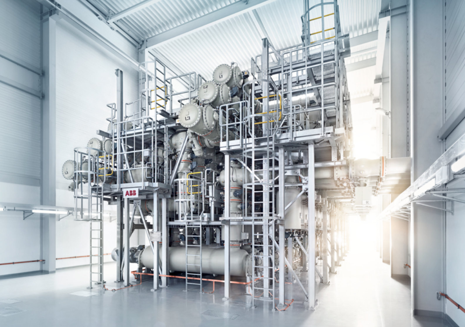
Gasisolierte Schaltanlage im Umspannwerk Weier
