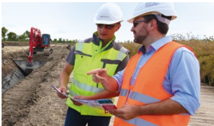
Besprechung auf der Baustelle: Die Bodenkundliche Baubegleitung bewertet die geplanten Baumaßnahmen und berät Bauherren und Bauleitung.
