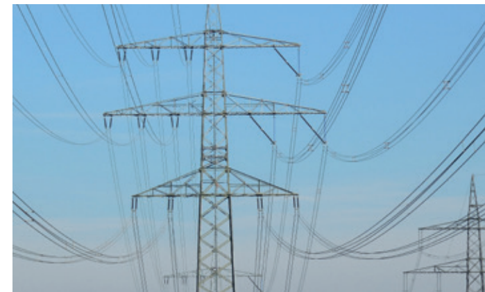
Bahnstromleitung Neckarwestheim-Zazenhausen: Die beiden oberen Traversen beinhalten rechts einen 380-kV-Stromkreis und links 110-kV-Stromkreise. Die unterste Traverse trägt zwei Systeme der DB Energie mit Viererbündel.
