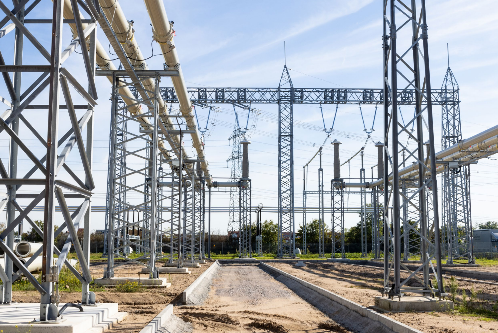
Das Umspannwerk Altlußheim
