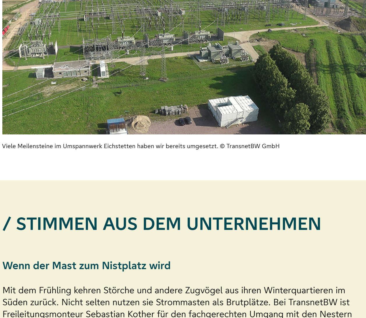
Viele Meilensteine im Umspannwerk Eichstetten haben wir bereits umgesetzt. © TransnetBW GmbH
