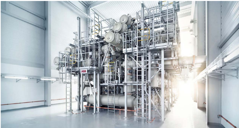
Gasisolierte Schaltanlage im TransnetBW Umspannwerk Weiher
