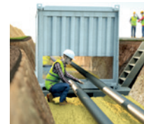
Die Kabelverbindung: Muffen
