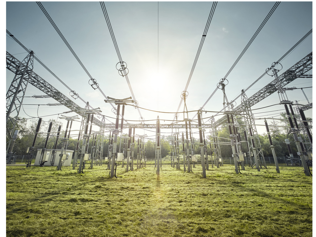
Das Umspannwerk Weinheim
